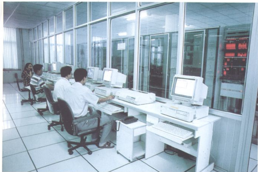
载波通信机房
