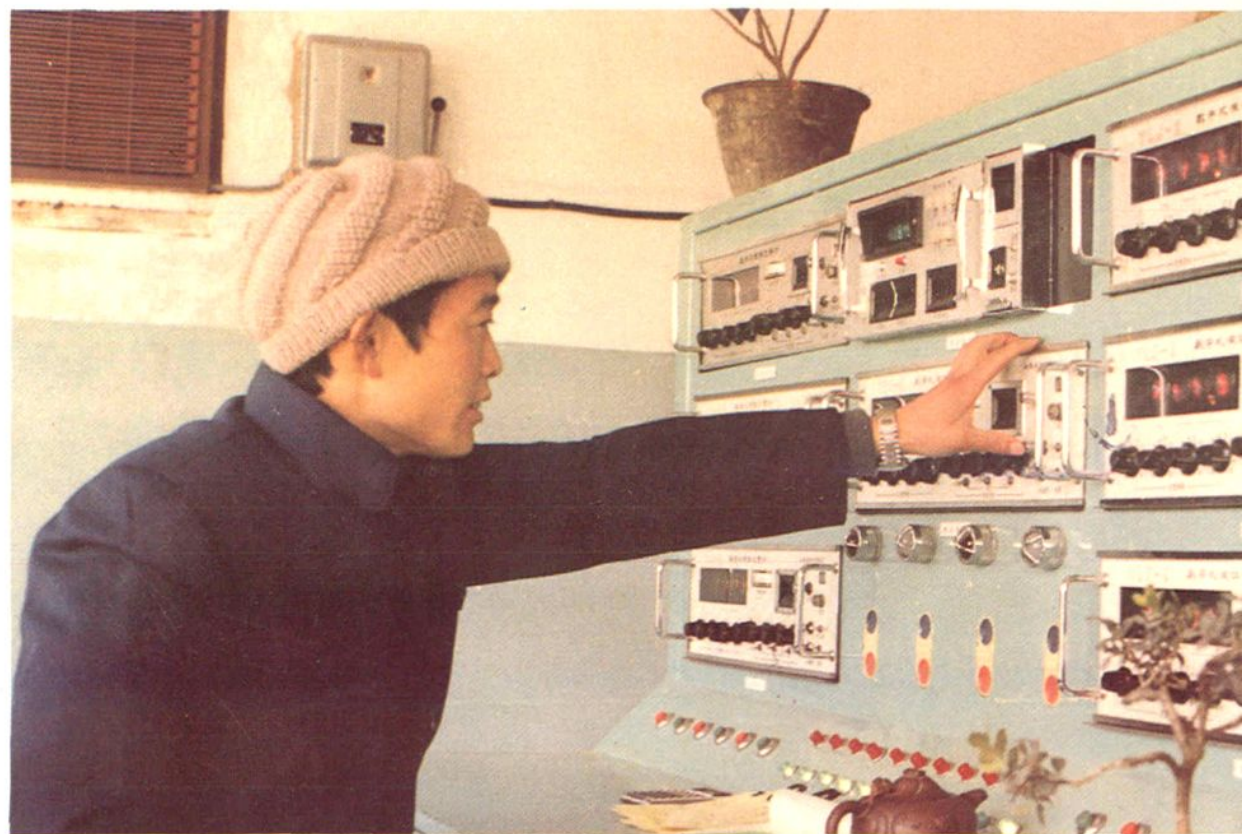
湖州苏台山油库电子数控付油仪表集中控制室
