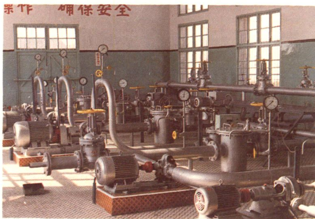
宁波石浦水封 油库码头泵房
