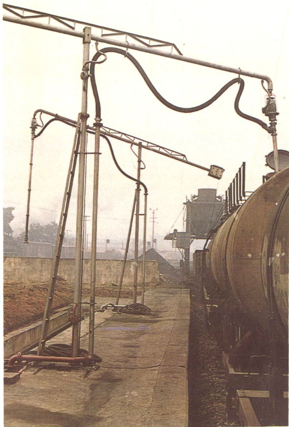
义乌油库铁路槽车卸油泵
