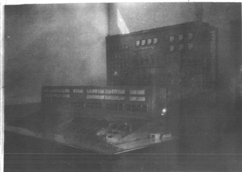
城关变电站控制台
