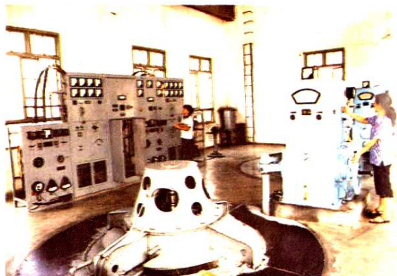
一级电站发电车间一角
