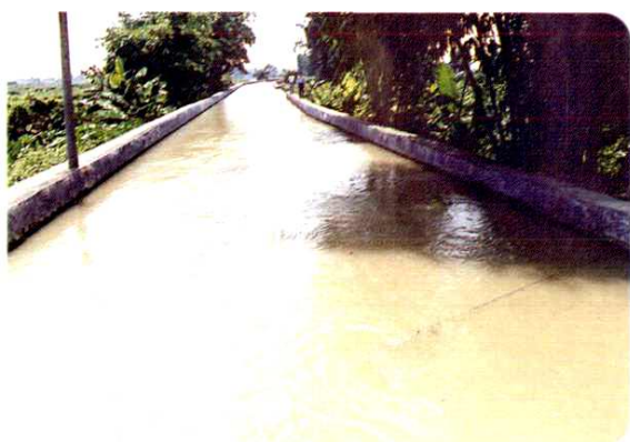
廊北二级电站发电水渠
