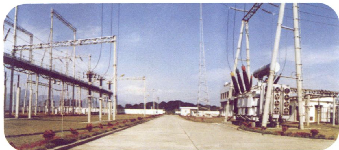
22 220 千伏莆美变电站
