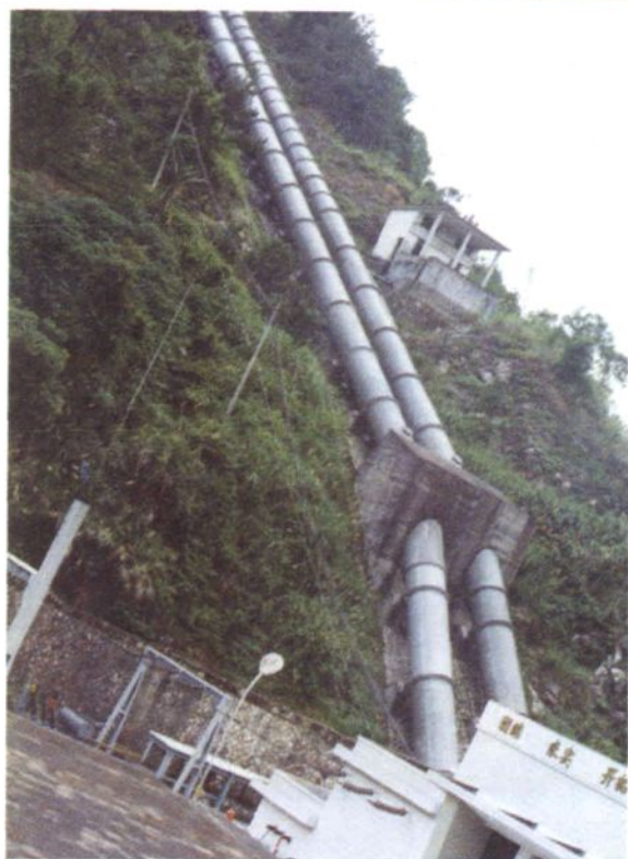
14 南靖船场溪水力发电厂装机 容量 2.5 万千瓦
