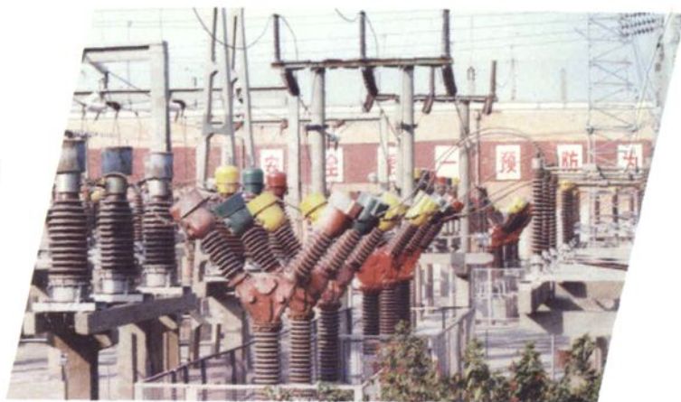
23 110 千伏东屿 变电站
