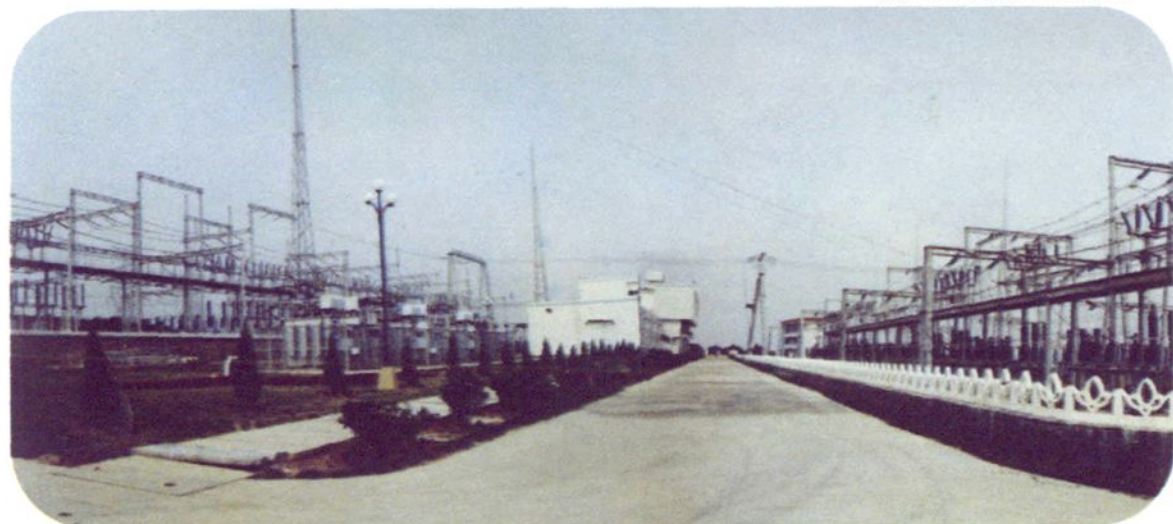
21 220 千伏角美变电站
