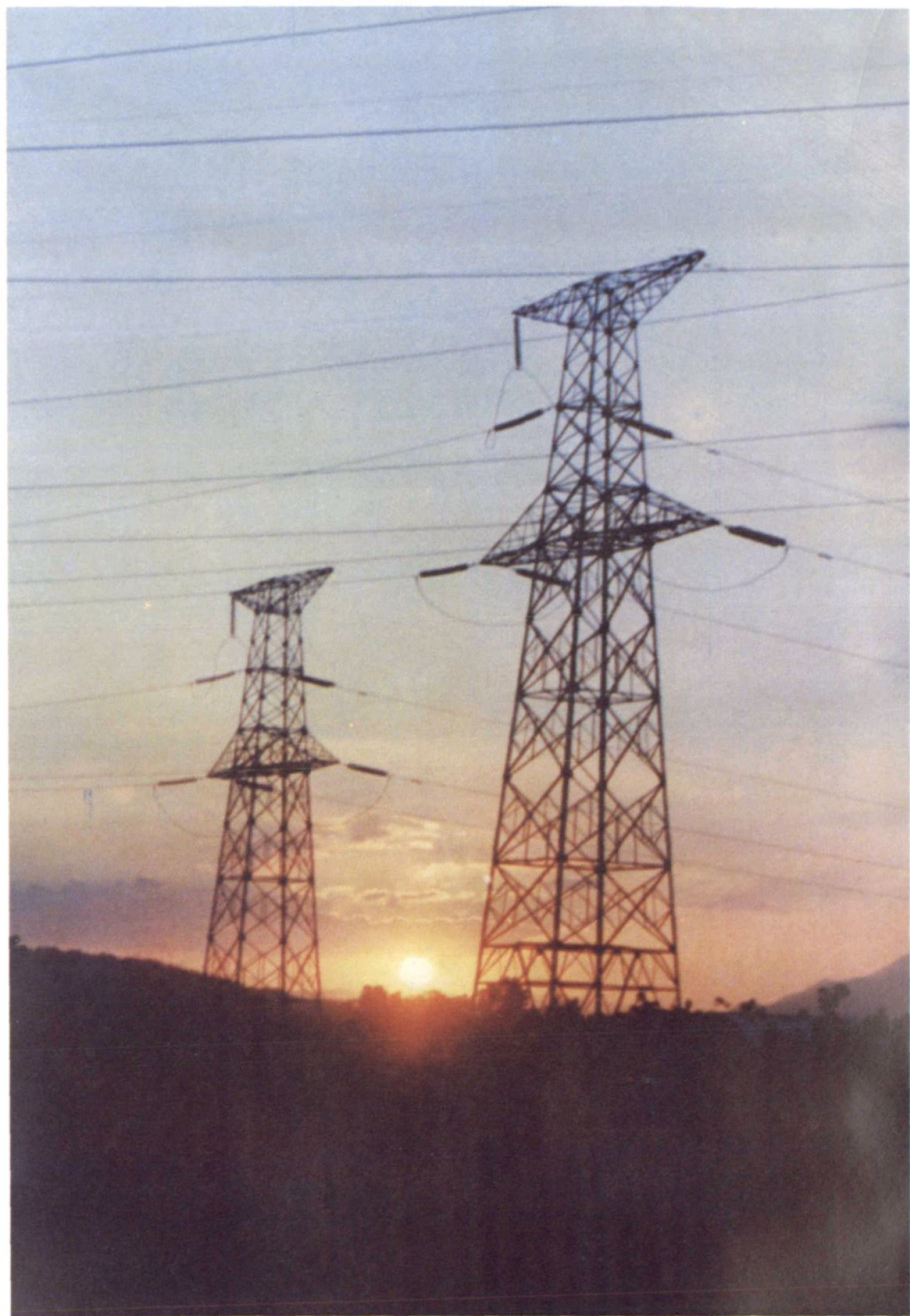
19 220 千伏漳平至漳州总山输电线路
