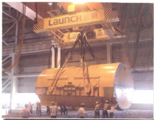
GYT-200液压提升装置
