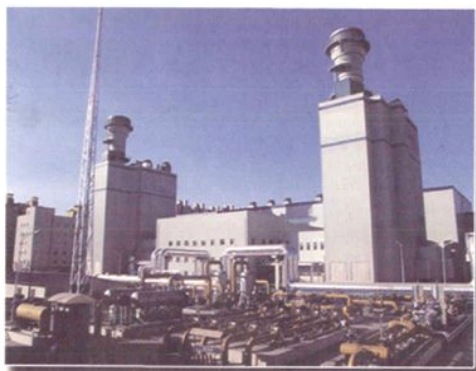
北京郑常庄燃气热电工程1号、2号机组
