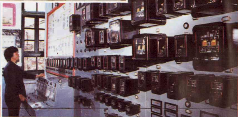
◀ 矿副井 3 米绞车房
