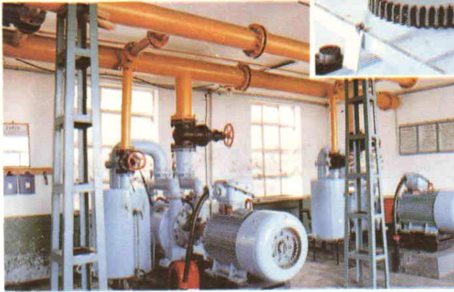
▼西北第一家瓦斯抽放系统——矿 瓦斯泵站一角
