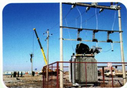
嵯岗35千伏变电站
