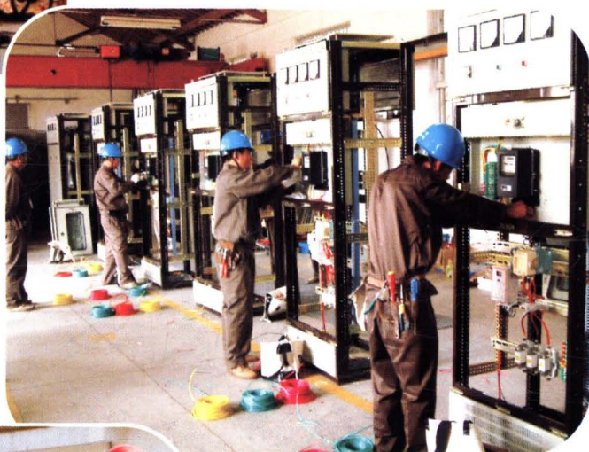
2002 年农电系统职工低 压电能计量柜安装技术比武
