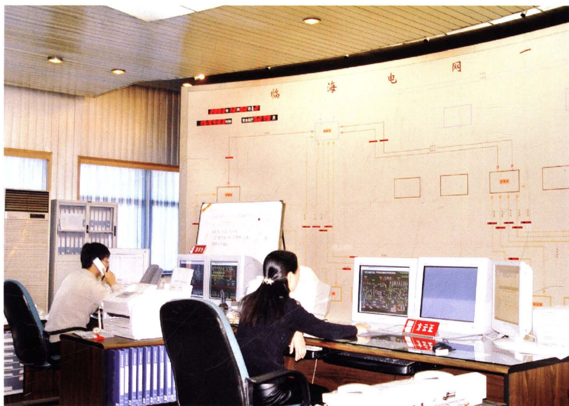
临海市供电局电力调度室
