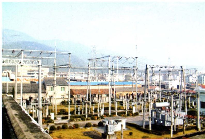
110 千伏良峰变电所
