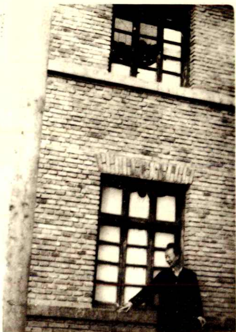
盐源中学未加固的教学楼， 地震墙体拉裂。
