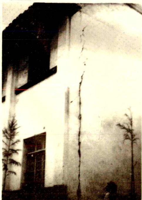
盐源国营食堂，砖柱土坯墙楼房， 地震墙体裂缝从脚到顶端。
