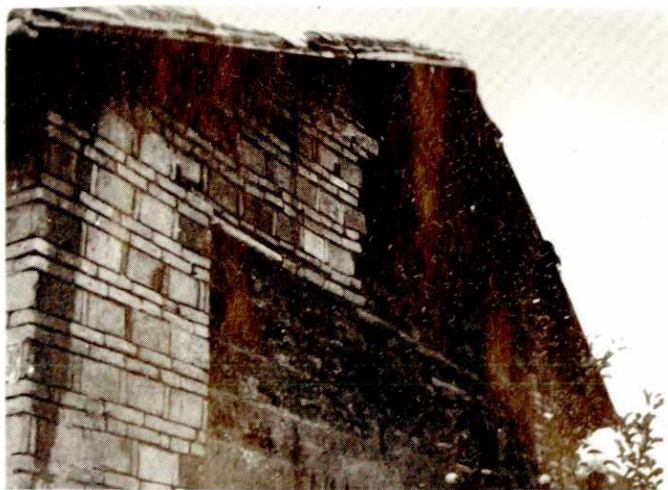
地震合哨花碉山墙垮塌
