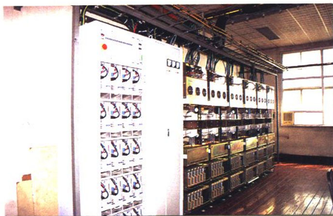
模拟移动通信基站设备
