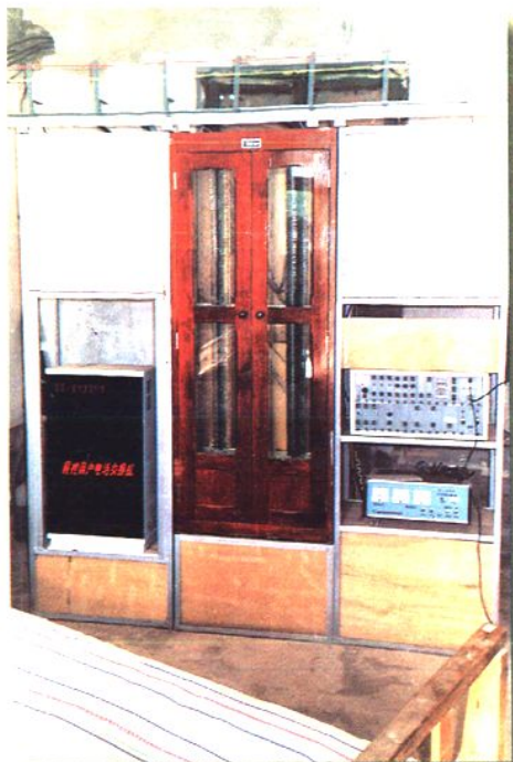
程控用户交换设备
