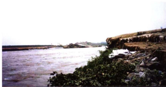
2001年8月1日，戴村坝中段乱石坝溃口现状
