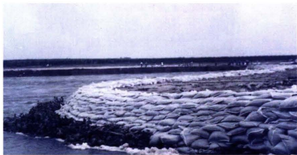
2001年8月2日，在戴村坝溃口两侧修筑了围堰，以免溃口扩大
