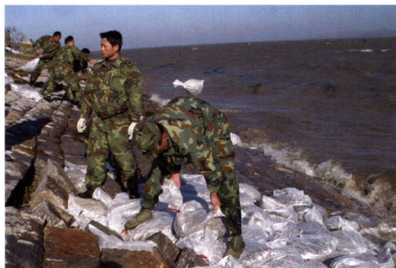
2003年10月14日，部队官兵抢护二级湖堤石护坡风浪坍塌险情
