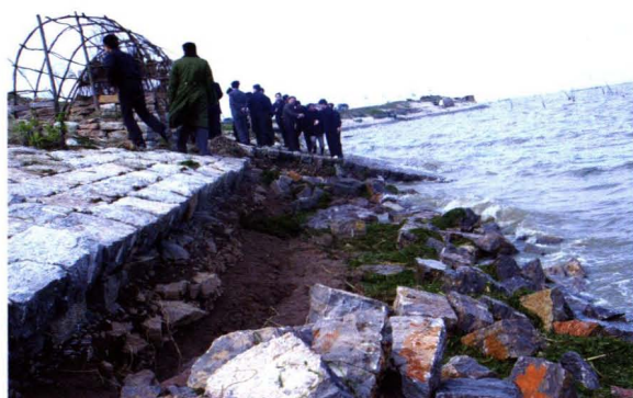
2003年10月，二级湖堤石护坡风浪坍塌险情
