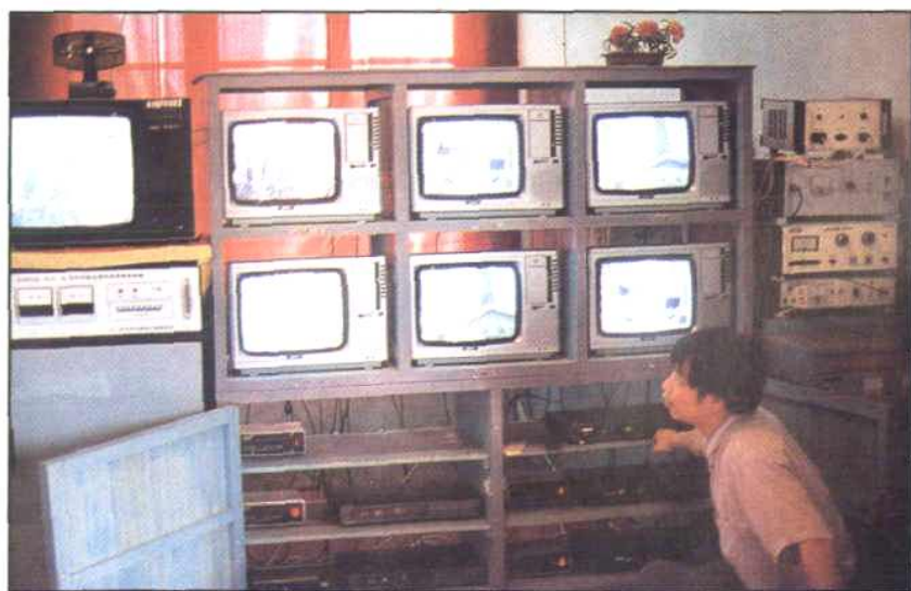
鄉有線電視機房
