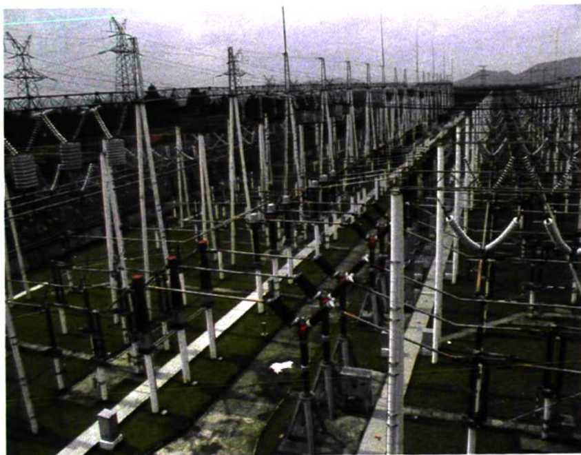
500kV 二田变电站的 220kV 出线间隔
