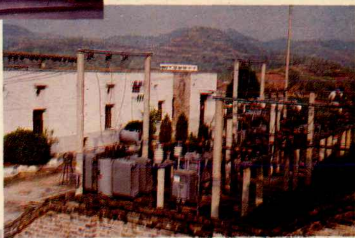
金龙山变电站
