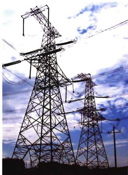
500KV输电线路
