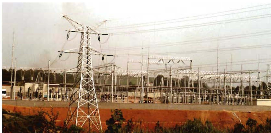
500千伏松桃变电站(主变终期容量3X750兆伏安), 2009年10月29日1号主变投运
