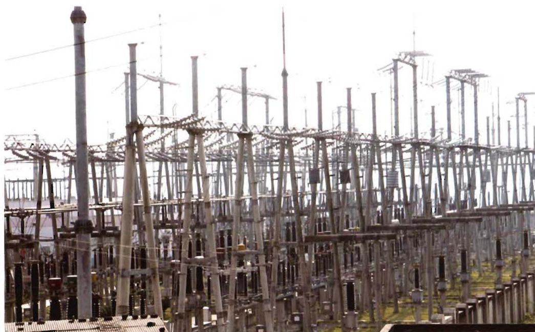
220千伏太平变电站(主变终期容量120+150+180兆伏安,是第一座正在改造的数字化电站
