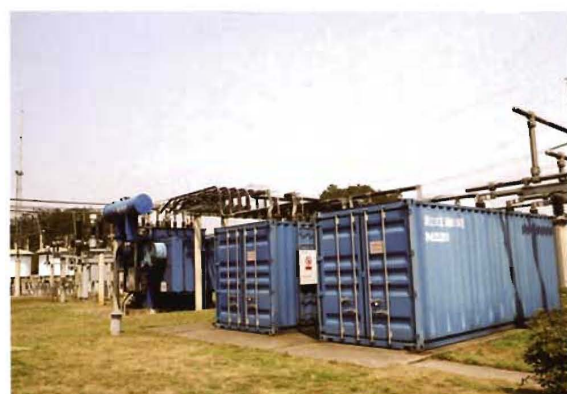
500千伏铜仁变电站 直流融冰装置
