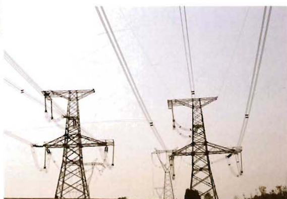
铜仁第一条500千伏 福(泉)铜(仁)输电线路
