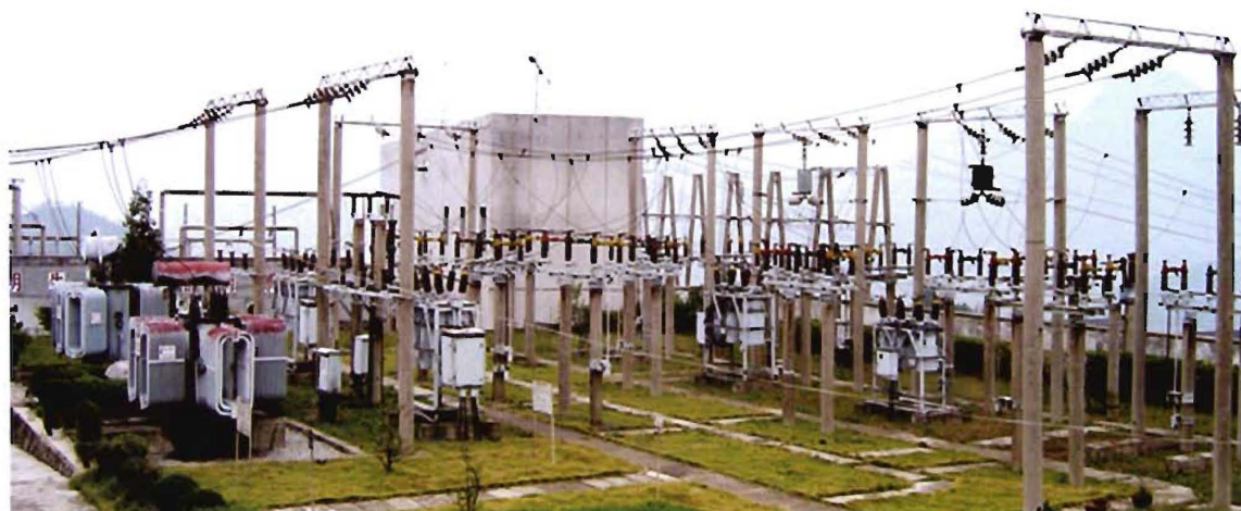
110千伏思南变电站(主变终期容量31.5+50兆伏安),1998年11月28日1号主变投运2010年2月3日2号主变投运,是第二座改造的数字变电站
