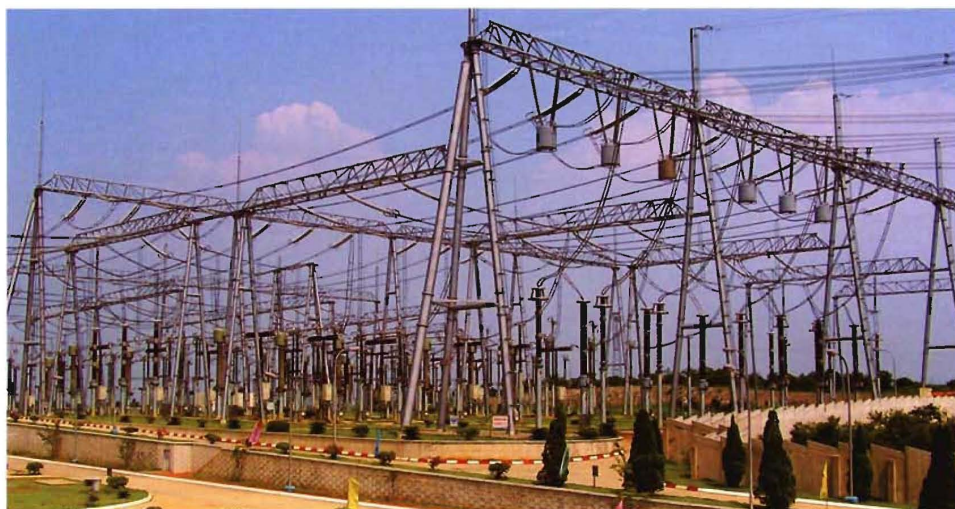
500千伏铜仁变电站(主变终期容量2X750兆伏安),是铜仁第一座建成的500千伏变电站
