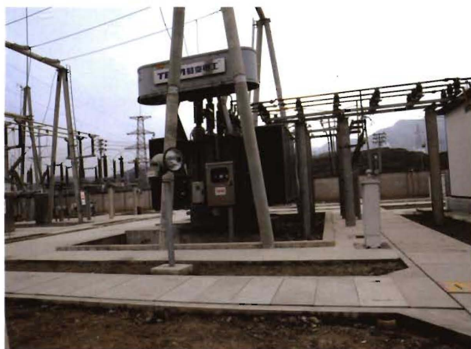
新建的110KV香树园数字化变电站, 主变容量40兆伏安
