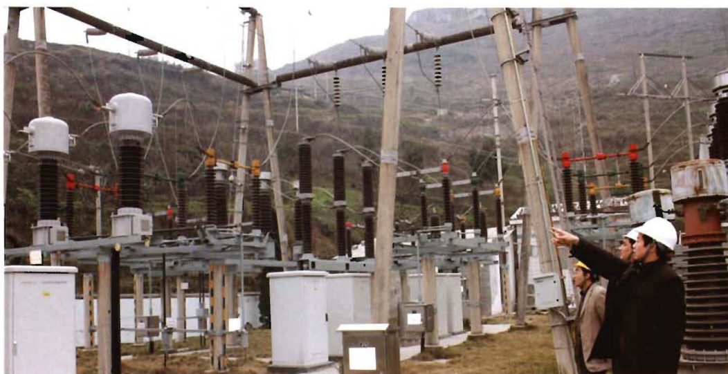
110千伏沿河变电站(主变终期容量20+31.5兆伏安),是第一座改造的数字化变电站
