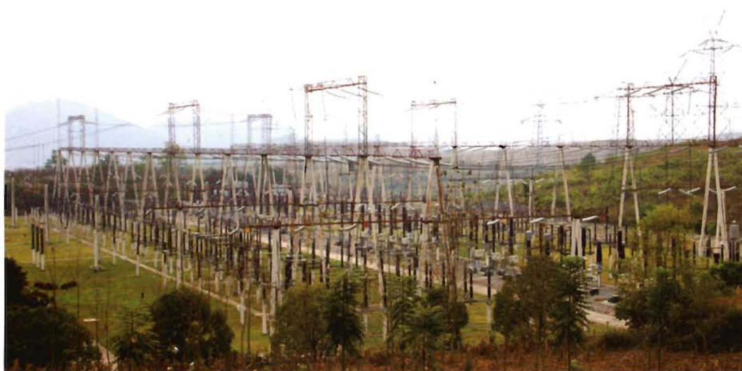
220千伏玉屏变电站(主变终期容量120+90兆伏安),1988年12月27日1号主变投运,是铜仁第一座建成的220千伏变电站
