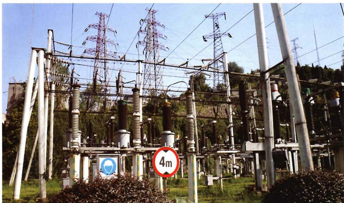
110千伏锦江变电站(主变终期容量2X40兆伏安),1987年 4月1号主变投运是全区第一座建成的110千伏变电站
