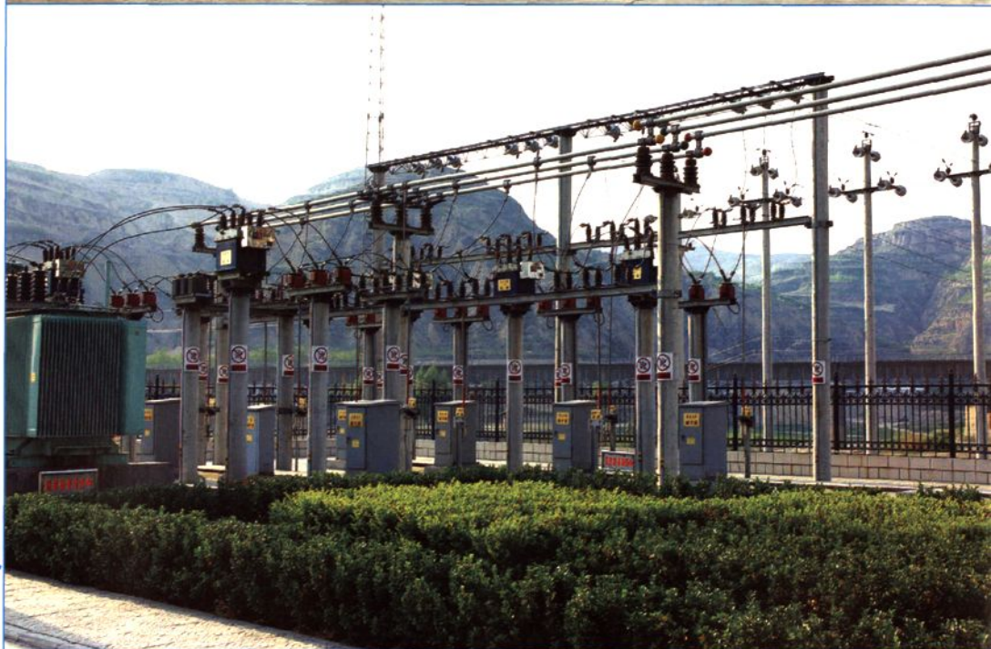
2006年1月13日投入运行的王家会35千伏变电站
