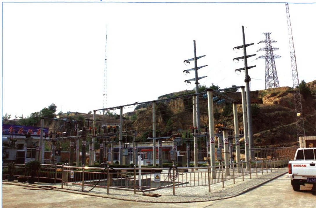
2005年11月27日投入运行的陈家湾35千伏变电站
