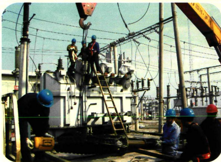
▶ 安康供电局变电处工人在检修主变压器
