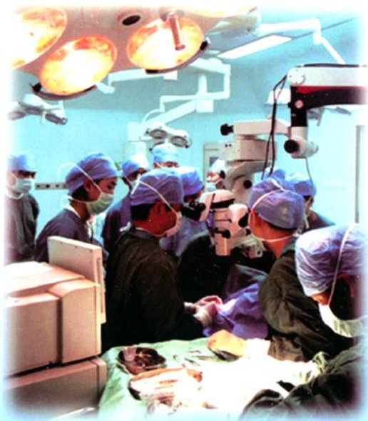
无菌、无尘、恒温、恒湿、恒压的国际标准 层流洁净手术室
