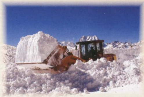
国道214线白马雪山路段保通
