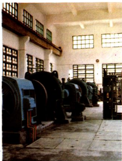
▲ 石门水电站主厂房
