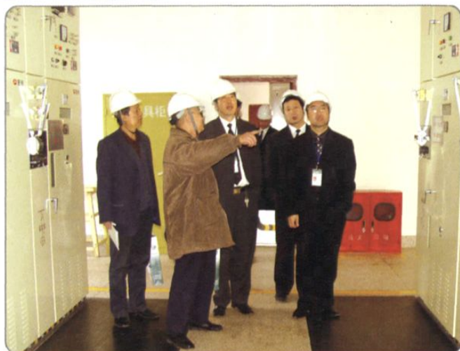
阳泉供电分公司总工程师兼副总经理卢永平同志 （右一）在郊区电业局进行规范化变电站检查
