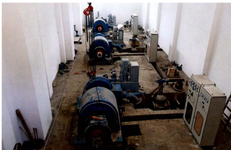
佳荣镇拉易水电站机房
