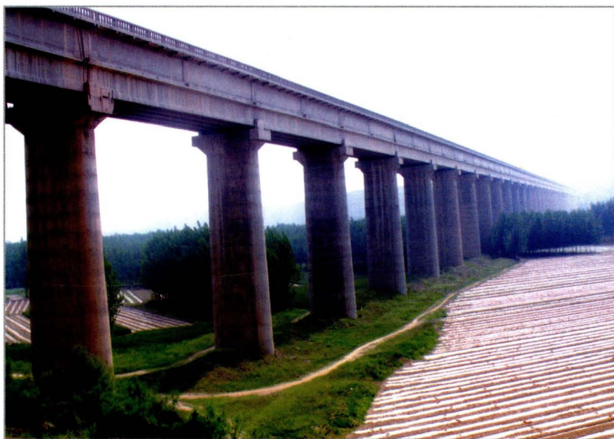
二期抽黄洛河渡槽
