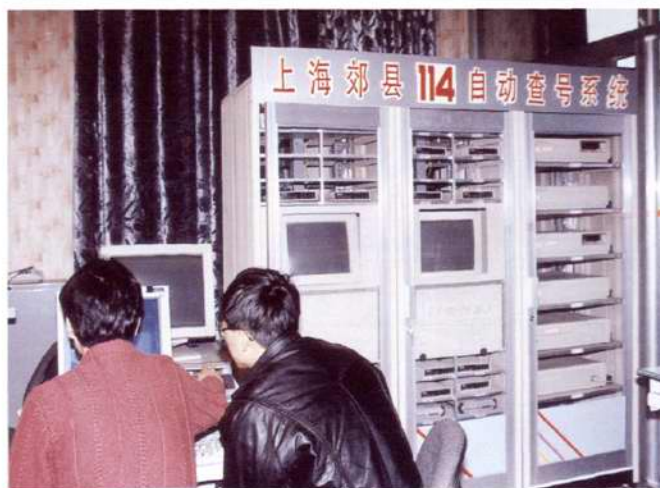
上海郊县114自动查号系统现场
