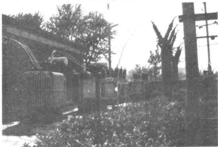
息县中渡店变电所主变
