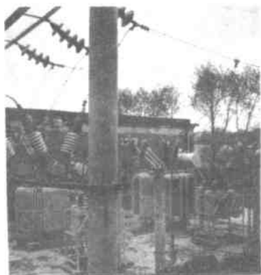
中渡店变电站
