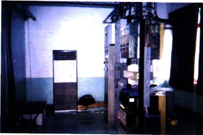
移动电话机房
