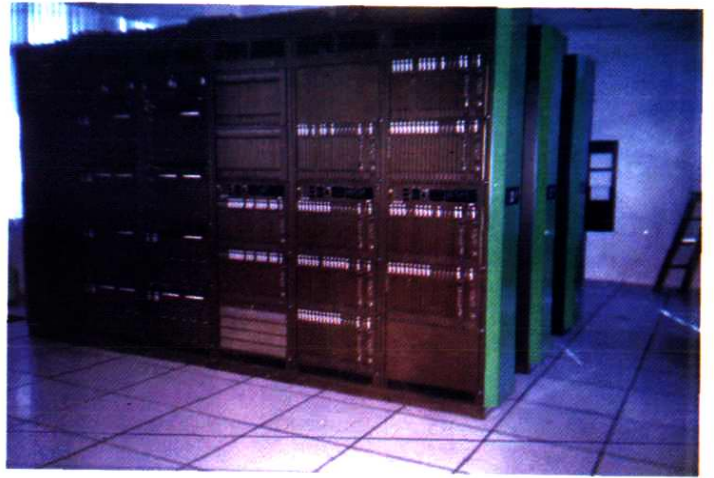
县局程控机房
