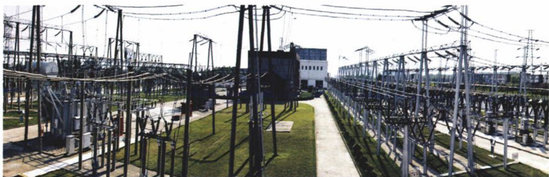
淮南供电公司金家岭变电所全貌
