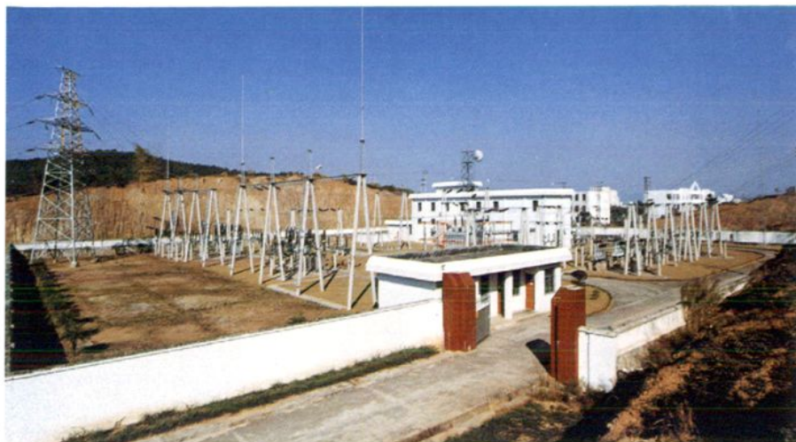
110千伏扶大变电站
