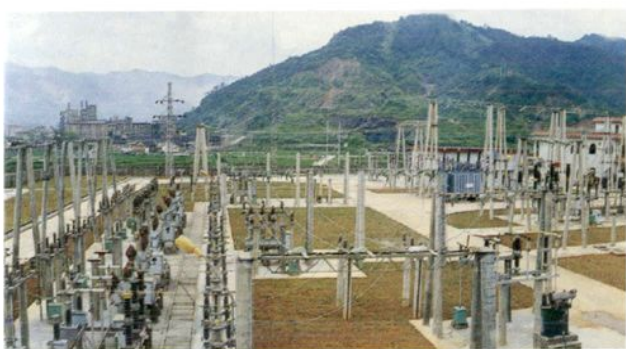
110千伏新铺变电站
