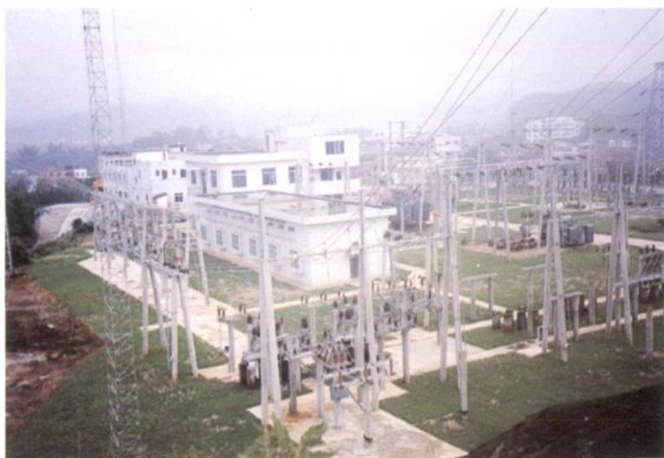
110千伏梅南变电站
