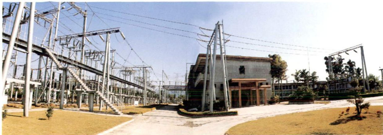
220千伏梅县变电站
