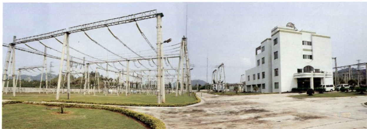
220千伏长沙变电站
