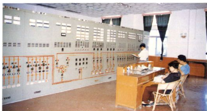
110千伏湖寮变电站主控室
