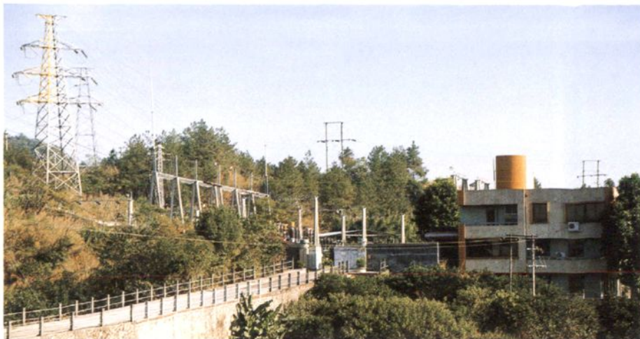
110千伏东山变电站
