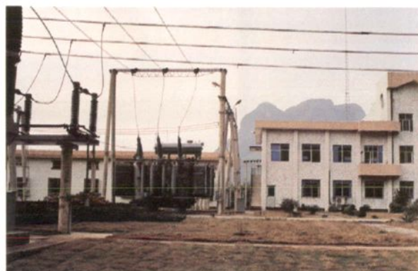
110千伏石正变电站
