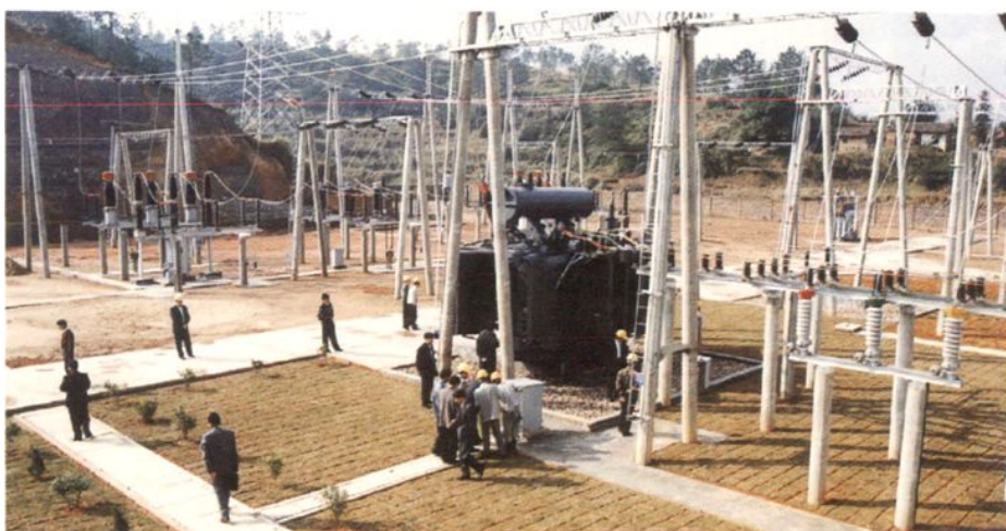
110千伏马鞍山变电站
