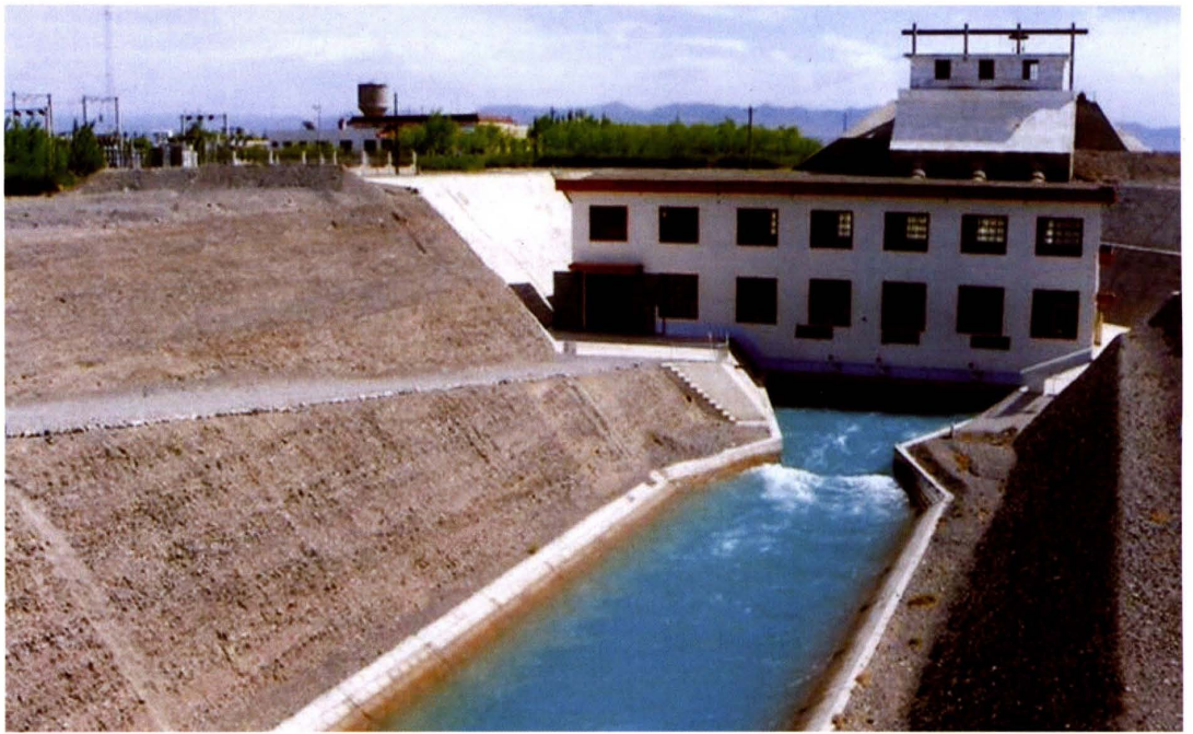
玉门市昌马总干渠梯级开发水电站
