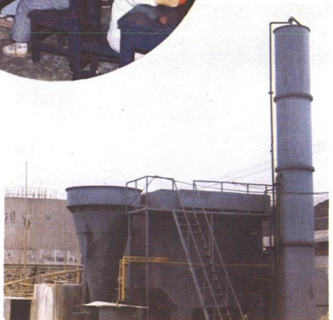
▽污水处理工程
