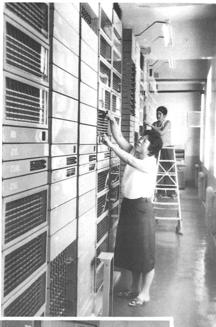
HJ—921 1000门纵横 制自动电话交换机房
