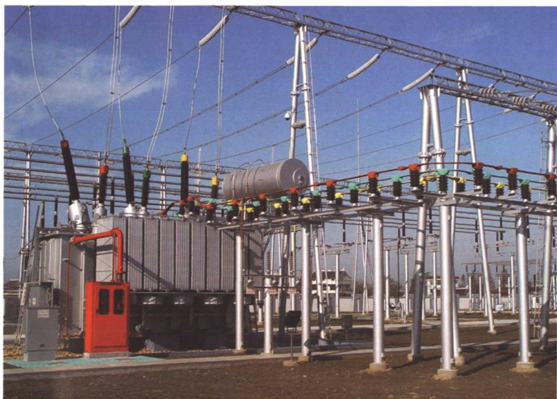
2005年投运的第二座220千伏变电所——姜灶变电所
