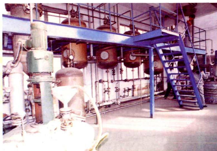
有机化工多功能中试装置
