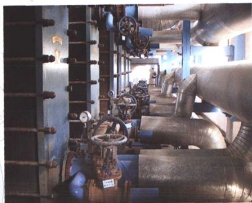
2006年12月，通辽热电公司运行中的供热换热站
