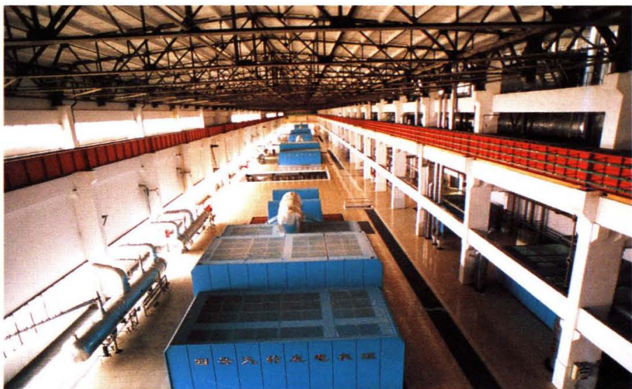
双辽发电厂汽轮发电机房
