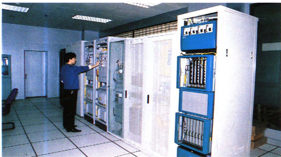
异步转移模式(ATM)通信设备机房
