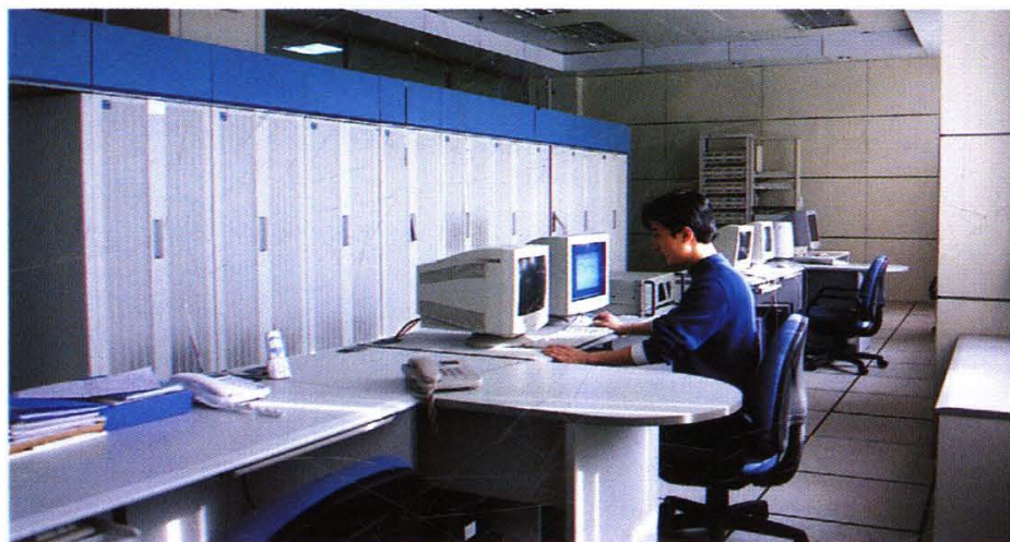
通信程控交换机房
