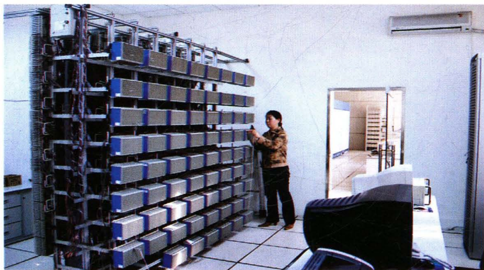
通信程控交换机配线架
