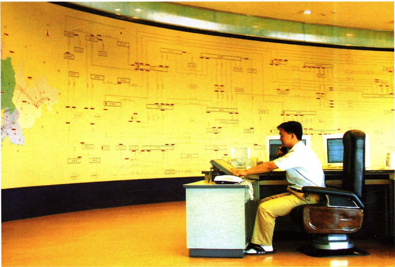
吉林省电网调度室
