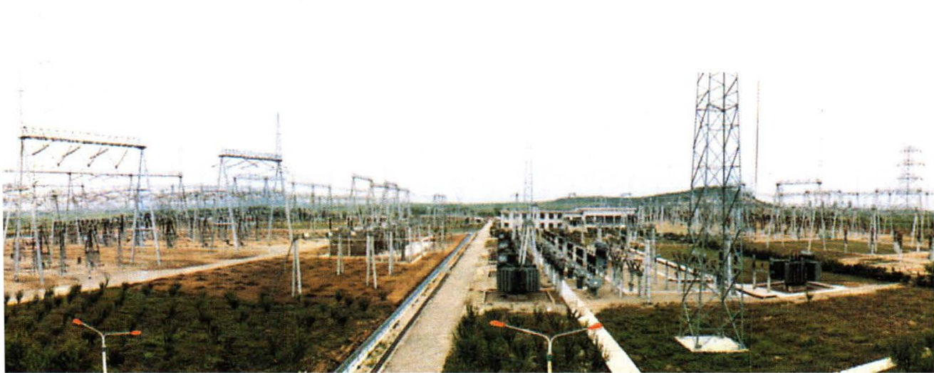
吉林最早投产运行的 500 千伏辽源东丰变电所(1986 年)
