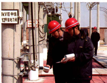
2007 年 4 月局安监 部门人员 在变电所 指导工作
