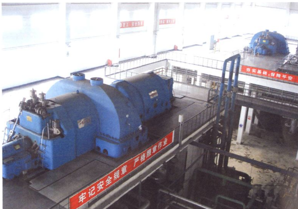
安溪煤研石火电厂发电车间
