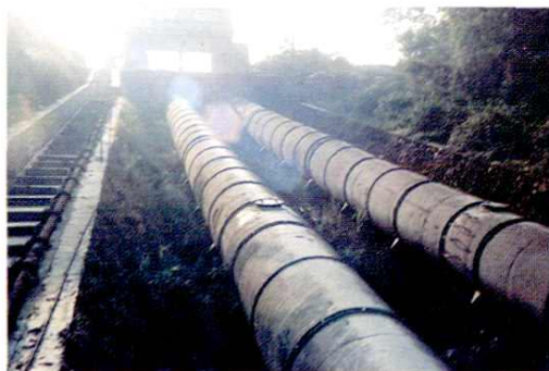
木梓电站压力管
