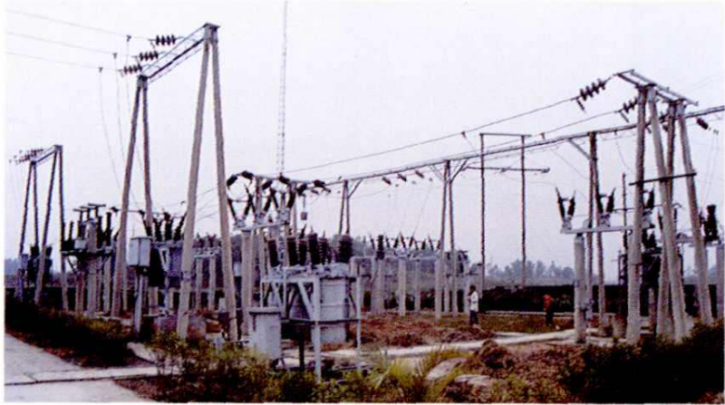
桥圩35kV变电站
