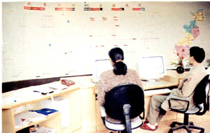
电力调度中心显示屏
