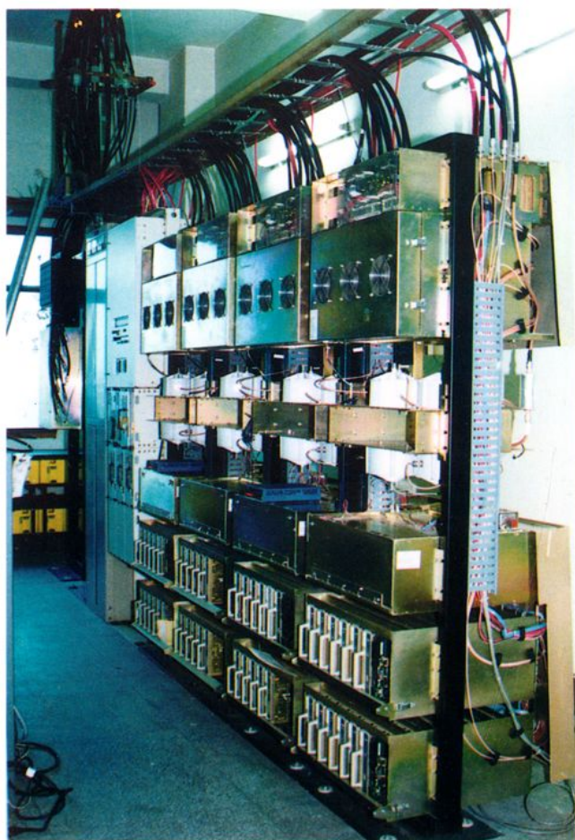
▼ 县局无线机房一角
