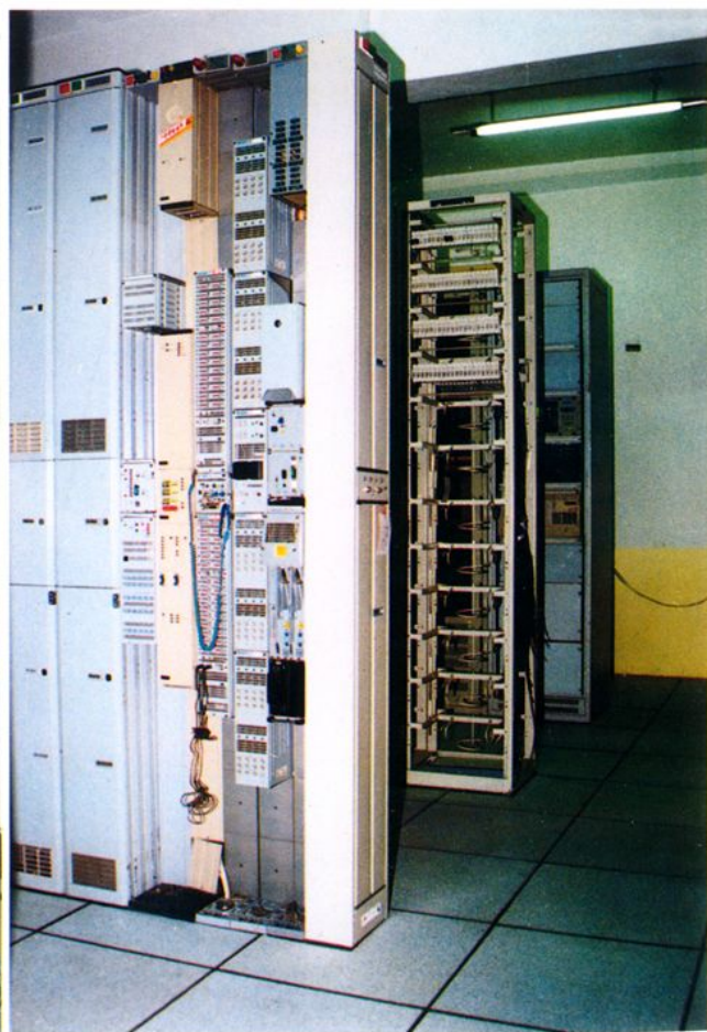
▼ 县局传输机房一角
