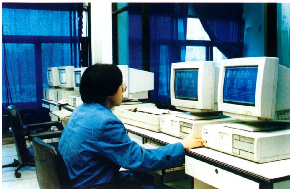
县局万门程控机 房一角
