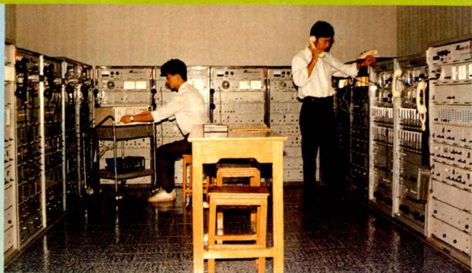
220 千伏江阴变电所 载波室
