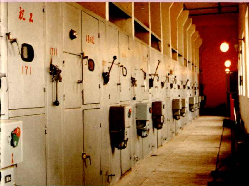
祝塘变电所 10 千伏开关室
