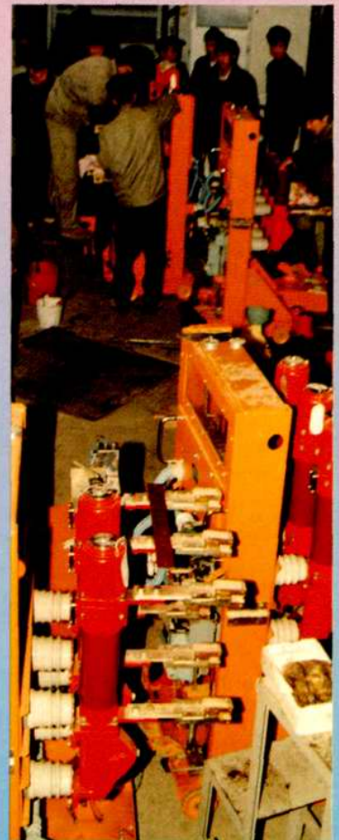
市供电服务公司调试开关
