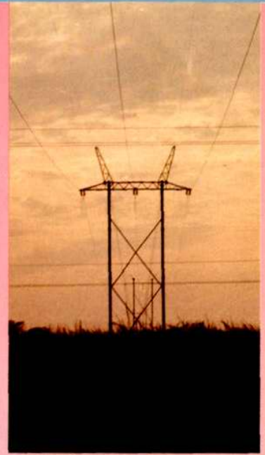
第一条 220 千伏线路
