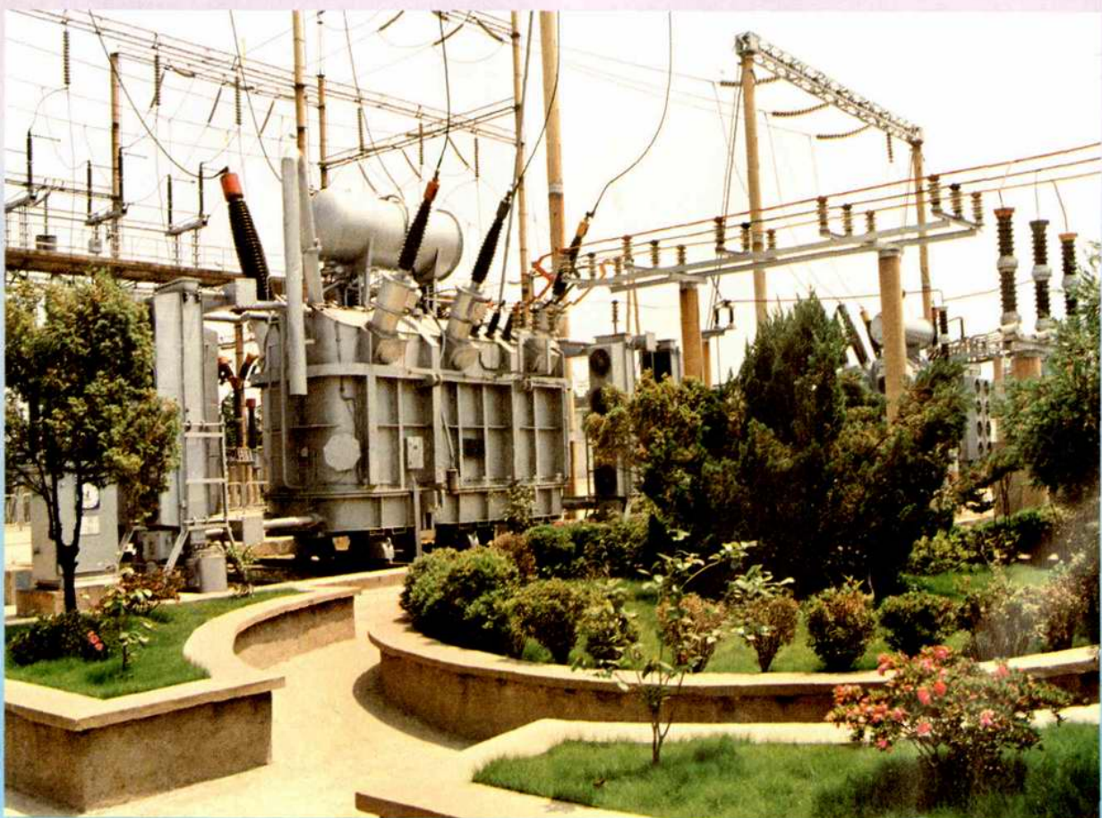
江阴第一座 220 千伏变电所——江阴变电所
