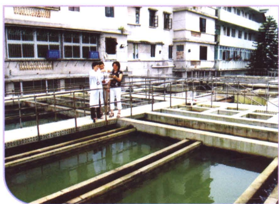
▲ 佛冈县自来水公司过滤净化池
