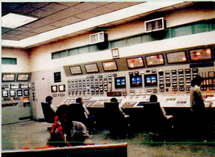
大坝发电厂集控室
