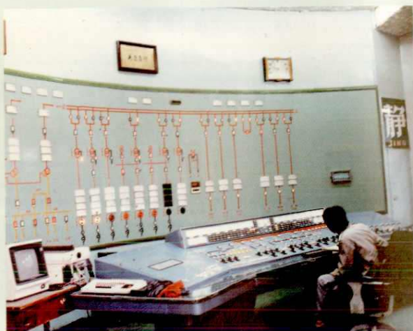
青铜峡水电厂主控制室
