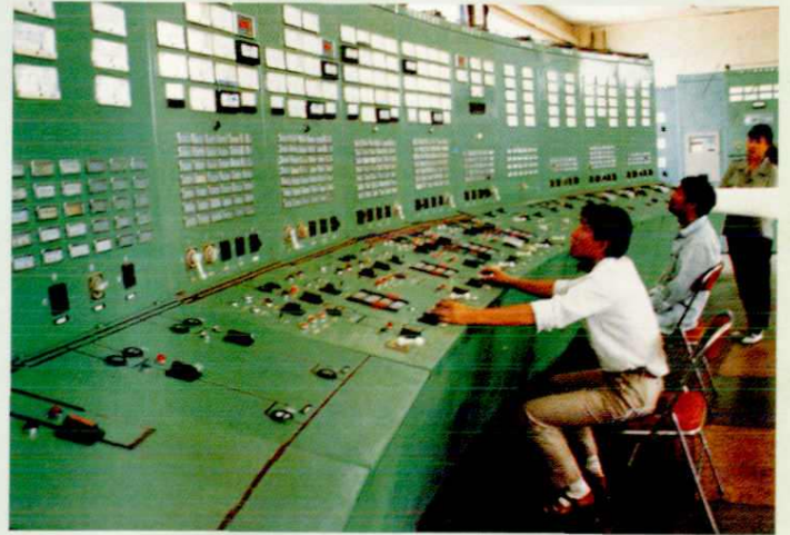
大武口发电厂主控制室
