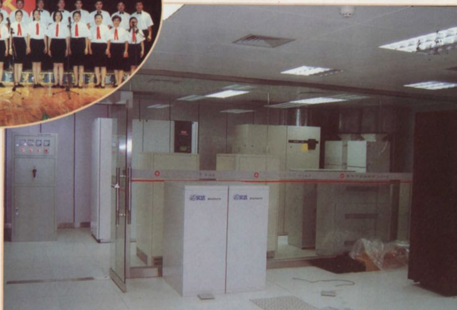
▼ 桂林市城市商业银行现代化中心机房
