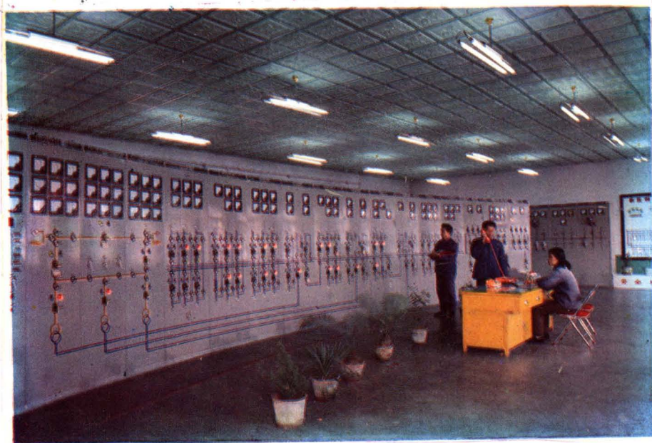
变电所控制室
