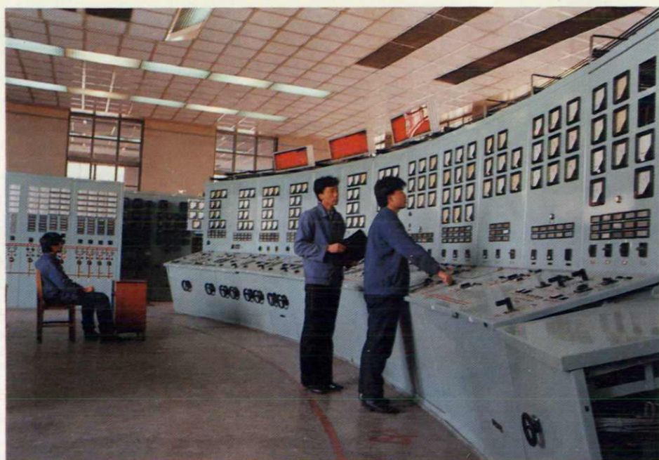
保定热电厂主控制室
