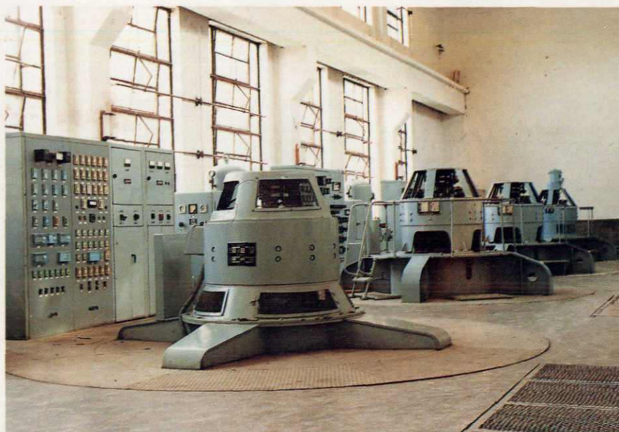
西大洋水电厂发电机组
