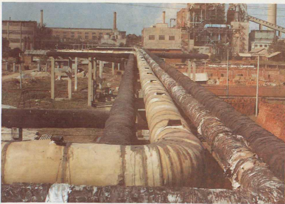
保定热电厂厂区南部热管道
