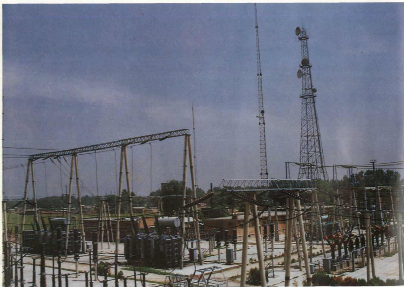
保定供电局高碑店220千伏变电站
