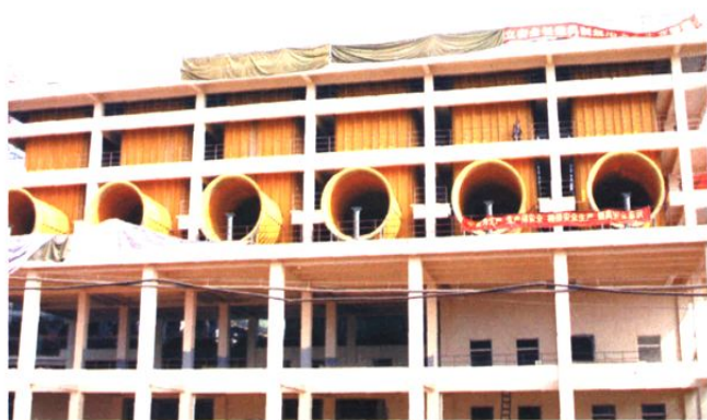
2004年12月的电解冷却塔
