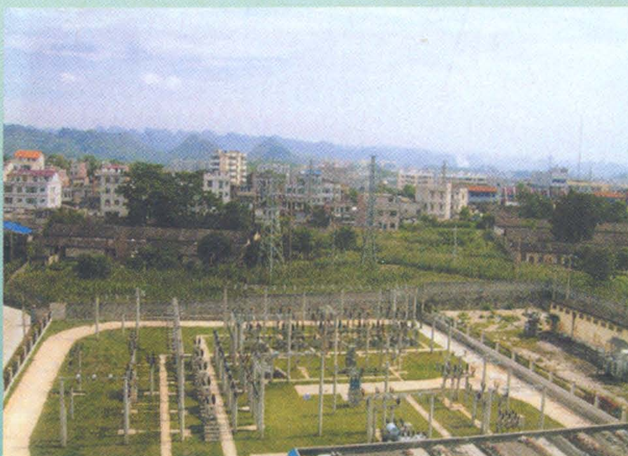
崇左35千伏变电站
