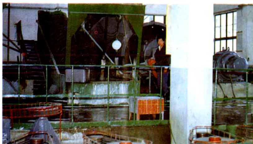
平度金矿选厂磨浮车间一角
