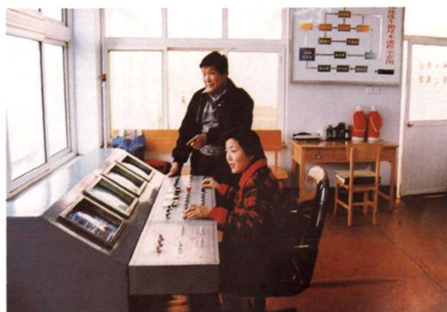
自动洗车台控制室
